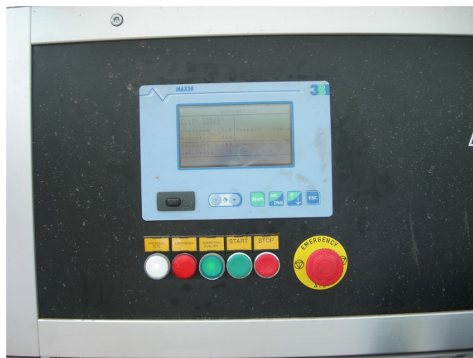
Figura 8 – Pannello di controllo
